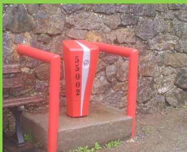
Bornes incendies rénovées
